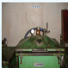
真空含浸設備
